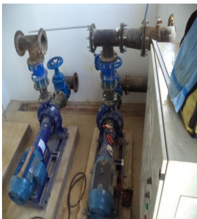
Foto 25: compartimento das moto bombas para distribuição de água.
