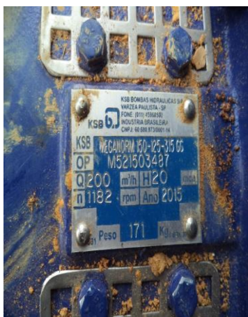
Foto 14: moto bomba para captação.
