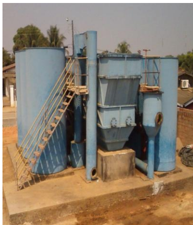
Foto 17: unidade de tratamento.
