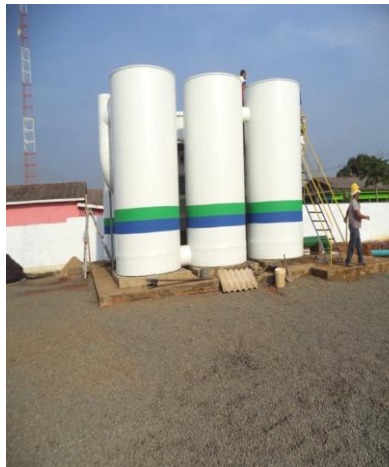
Foto 21: unidade de tratamento com capacidade de tratar em média 30 L/s.
