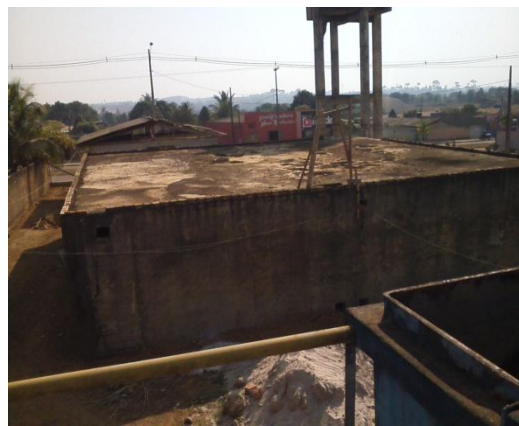
Foto 18: área de reservação com capacidade de 500m 3 não conformidade, apresenta rachaduras e ferragens expostas.
