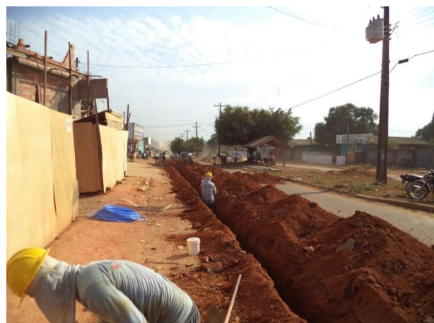
Foto 03: escavação e assentamento de tubulação 100mm de PVC -PBA no trecho da Avenida Porto Velho.
