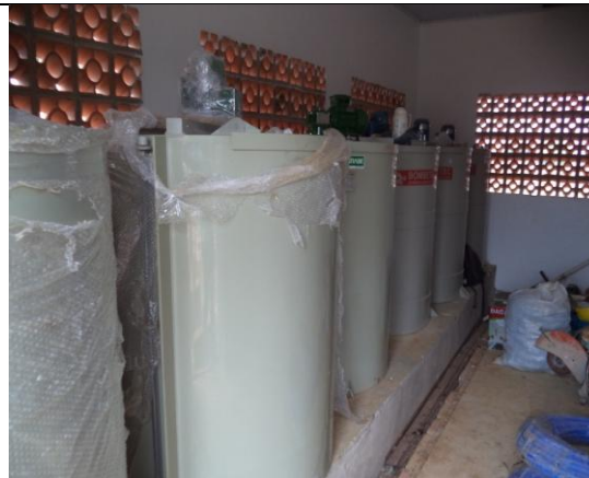
Foto 27: compartimento de armazenagem dos tanques de dosagem de cloro, sulfato de Alumínio e flúor.
