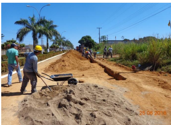
Foto 01: início das escavações e assentamento de adutora de 400mm de FoFo trecho da Avenida Ayrton Senna.
