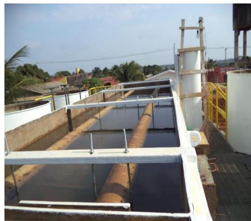
Foto 22: vista sobre o sistema de tratamento, água passando pelo processo de tratamento.
