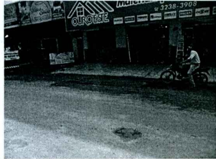
Foto 06: base sem CM 30 podendo comprometer O asfalto.
