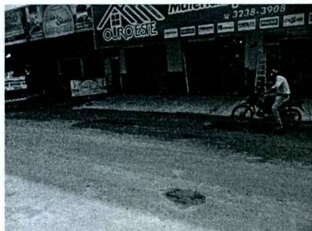
Foto 06: base sem CM 30 podendo comprometer O asfalto.
