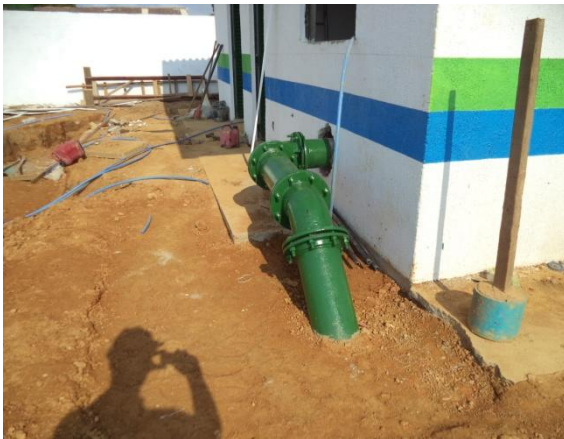
Foto 03: conexão das tubulações à bombas de pressão.
