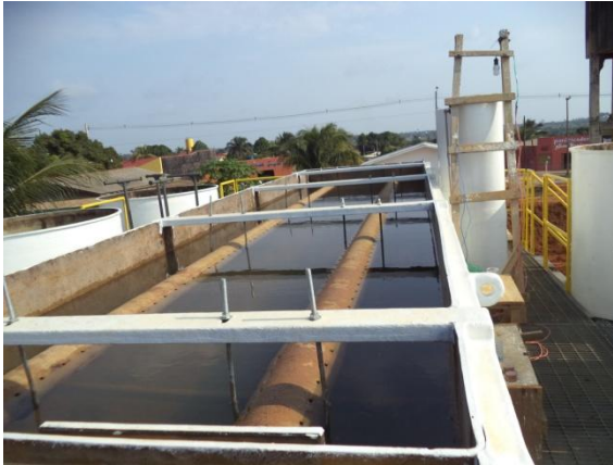
Foto 01: unidade de tratamento
