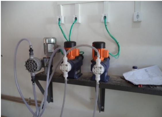
Foto 02: dosadores automatizados de Cloro e de Sulfato de Alumínio.
