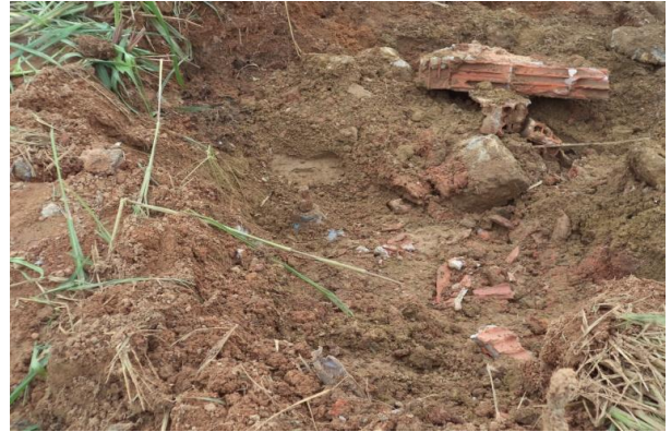
Foto 02: descarga 10 soterrada e caixa destruída.
