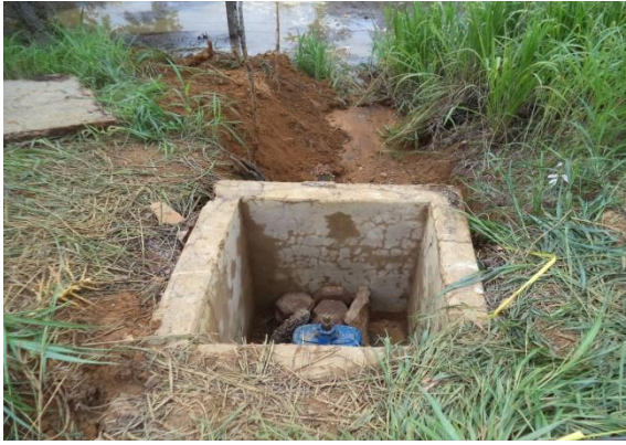
Foto 01: rompimento da bolsa na descarga com a pressão exercida pela bomba.
