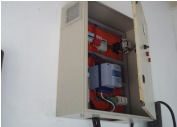
Foto 02: painel instalado provisoriamente.
