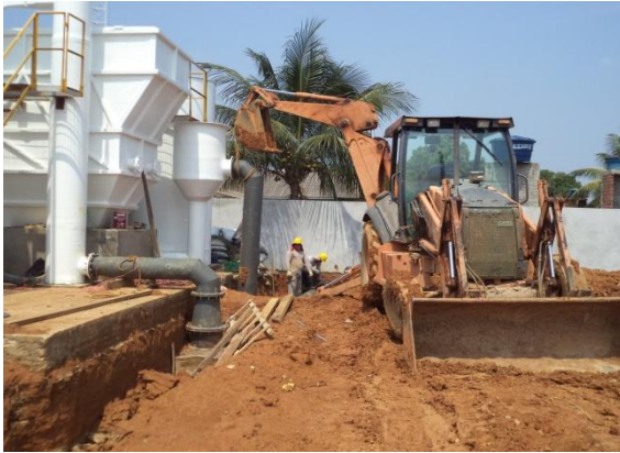
Foto 01: ligação da unidade de tratamento com a rede de adutora e rede de distribuição.
