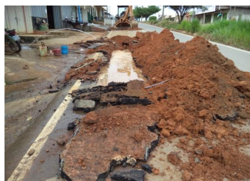
Foto 03: rompimento da tubulação de 100mm de PVC – PBA .
