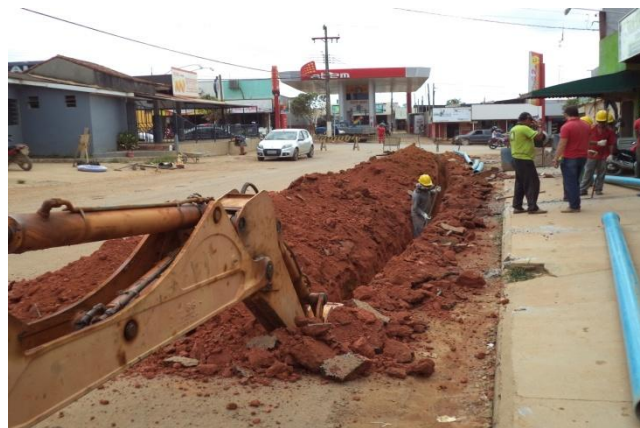
Foto 02: escavação e assentamento de tubulação de 150mm de FoFo na Rua Iguaçu.
