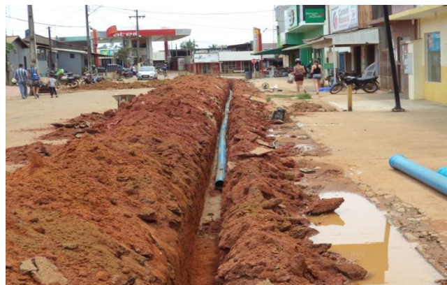
Foto 03: tubos de 150mm de FoFo com os ramais.
