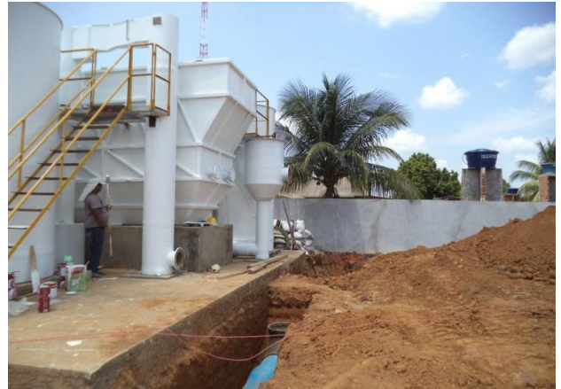
Foto 05: assentamentos de tubos de 400mm e de 300mm Ambos de FoFo em conectados a unidade de tratamento.
