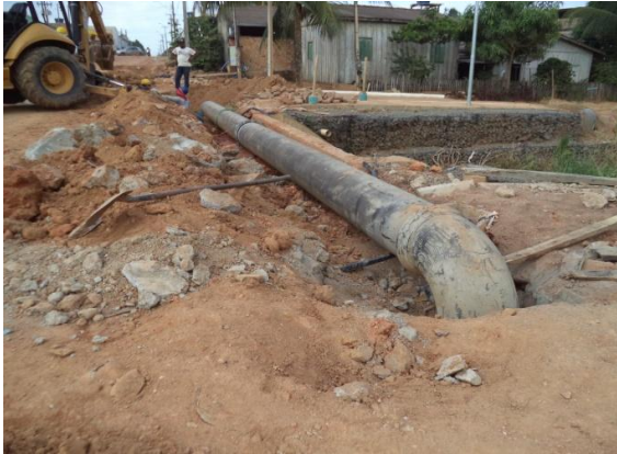
Foto 01: adutora de ferro fundido sobre a passarela do canal da cidadania.
