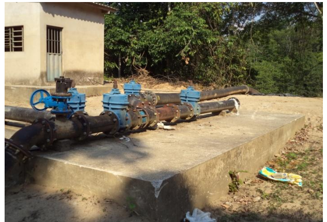
Foto 04: base da captação junto a adutora interligado ao flutuante.
