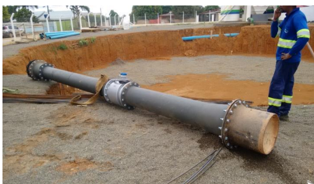
Foto 01: instalação de sensor de vazão de água bruta.
