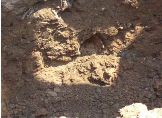
Foto 01: tubulação rompida ocasionando a infiltração.
