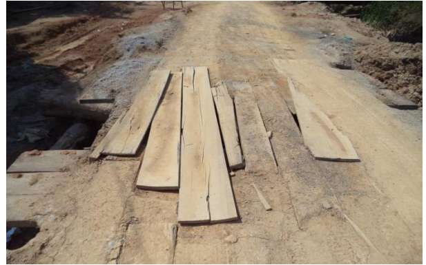
Foto 04: situação da ponte ao ser realizada a passagem da adutora de água bruto de 400mm de ferro fundido sob a ponte do igarapé do setor 02.
