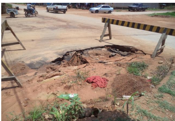
Foto 01: afundamento do asfalto na rotatória Avenida Porto Velho Com a Monte Negro.
