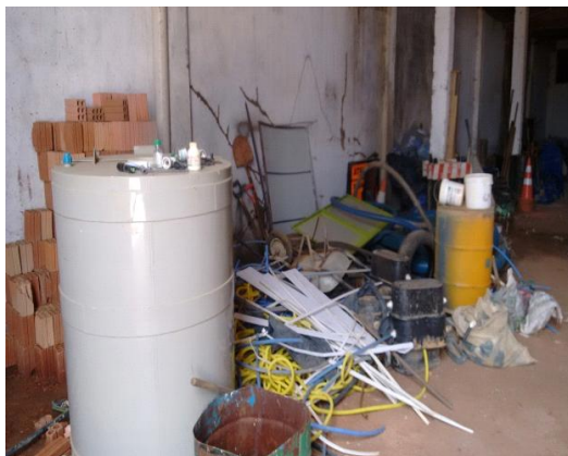
Foto 02: presença de entulho no local – inconformidade.
