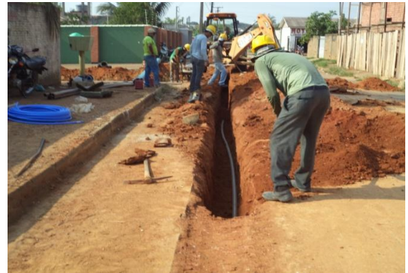
Foto 05: assentamento de tubulação de 200mm de FoFo e de 50mm de PVC – PBA com 3 Ts de ferro fundido para distribuição de água.
