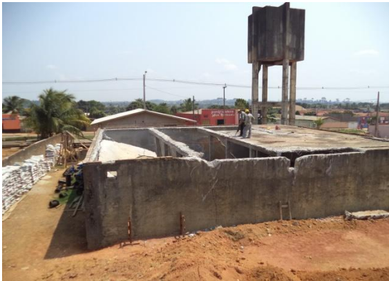
Foto 02: ETA - demolição da área de reservação de água de 500m 3 em concreto.
