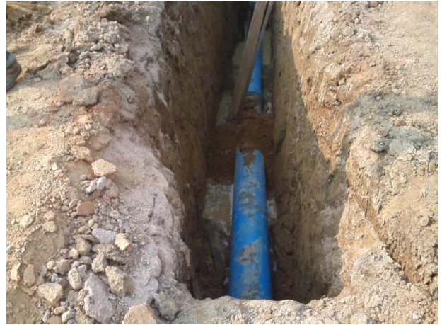
Foto 02: assentamento de adutora de 400mm de ferro fundido e de FoFo no igarapé do setor 02.
