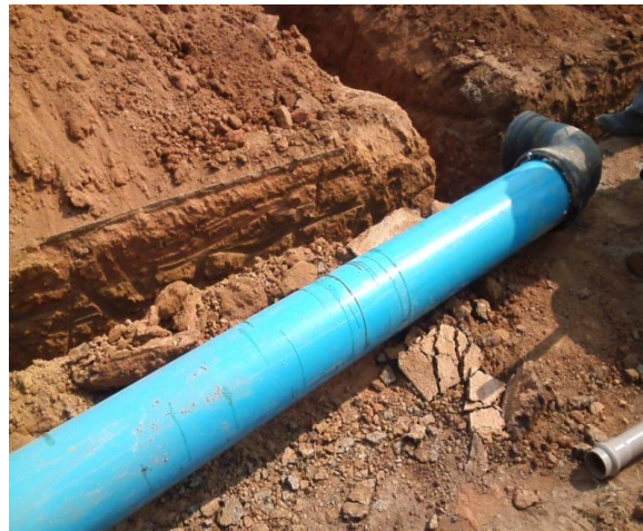
Foto 02: assentamento de tubulações de 200mm de FoFo, 50mm e PVC e duas curvas de 90º de ferro fundido.
