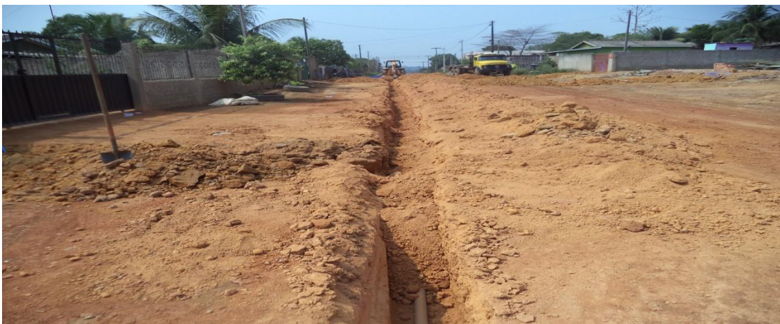
Foto 03: assentamento de rede de água com tubos de 50mm de PVC – PBA.
