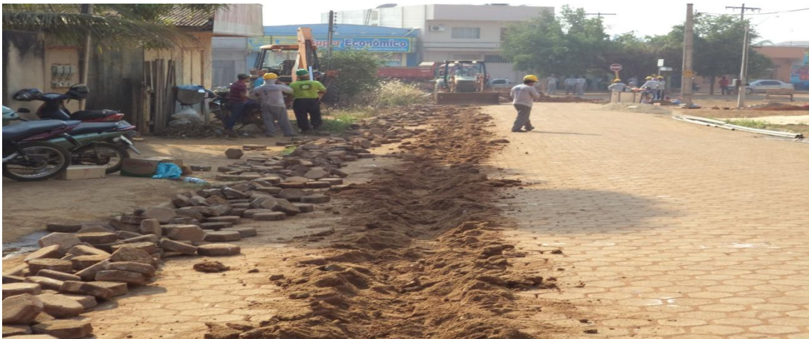
Foto 02: assentamento de rede de distribuição de água com tubos de 50mm de PVC – PBA.
