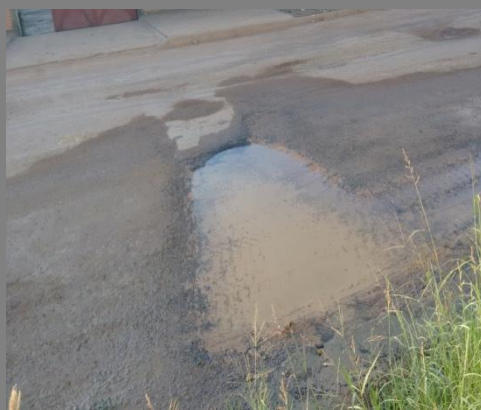
Foto 03: afundamento do asfalto devido ao acúmulo de água.
