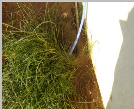
Foto 02: rompimento do ramal.
