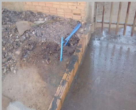
Foto 01: rompimento do ramal.
