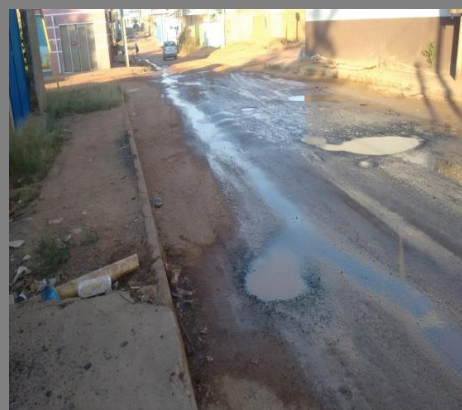
Foto 04: buracos no asfalto devido ao acúmulo de água.
