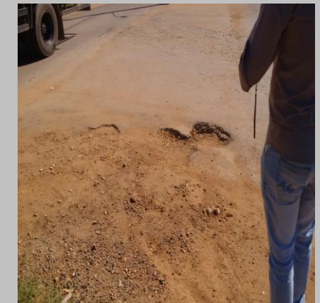
FOTO 06: afundamento da base.
