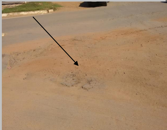
FOTO 05: rachaduras e comprometimento da base.
