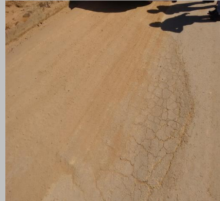
FOTO 02: rachaduras e afundamento local comprometimento da base.
