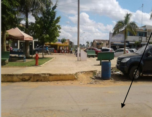
FOTO 10:afundamento com rachadura no pavimento.
