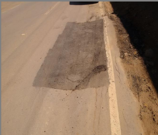
FOTO 09: afundamento da base com rachadura.
