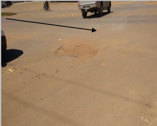
FOTO 07: afundamento da base comprometendo o pavimento.
