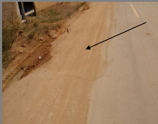
FOTO 03: rachaduras e afundamento local comprometimento da base.
