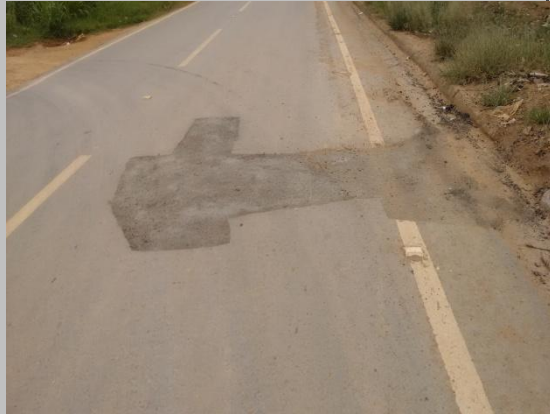
FOTO 01- apresenta afundamento da base.
