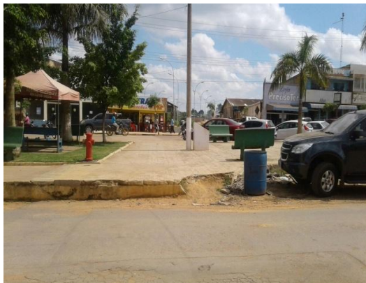
FOTO 10:afundamento com rachadura no pavimento.
