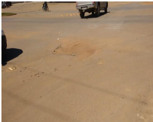
FOTO 07: afundamento da base comprometendo o pavimento.
