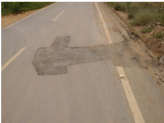
FOTO 01- apresenta afundamento da base.
