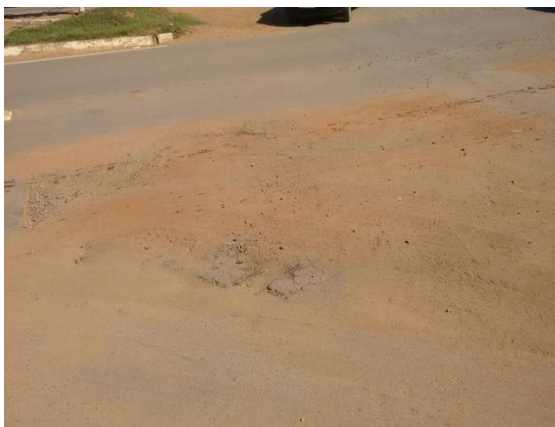
FOTO 05: rachaduras e comprometimento da base.
