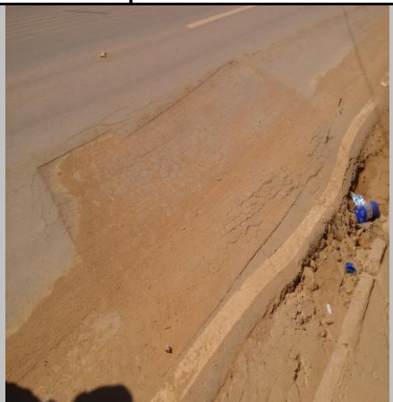
FOTO04:afundamento local e comprometimento da base.
