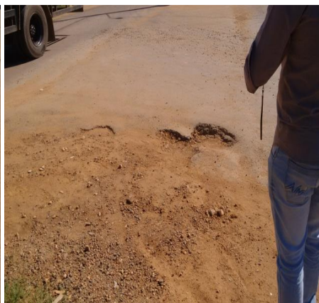
FOTO 06: afundamento da base.
