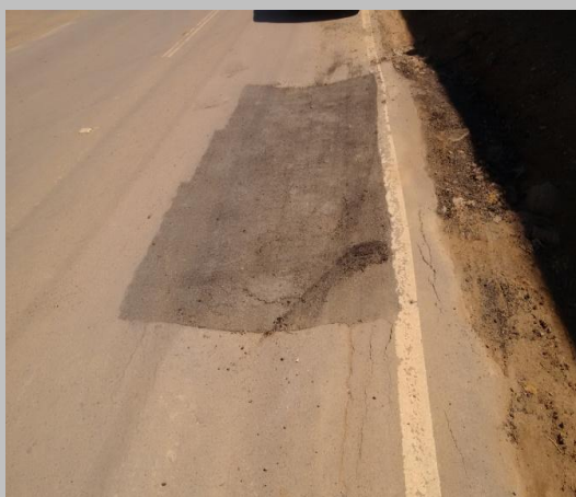
FOTO 09: afundamento da base com rachadura.
