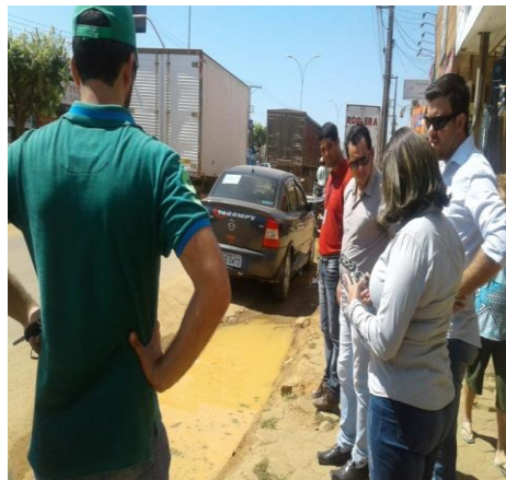
FOTO 08: afundamento do asfalto com rachaduras.
