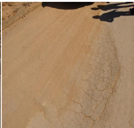
FOTO 02: rachaduras e afundamento local comprometimento da base.
