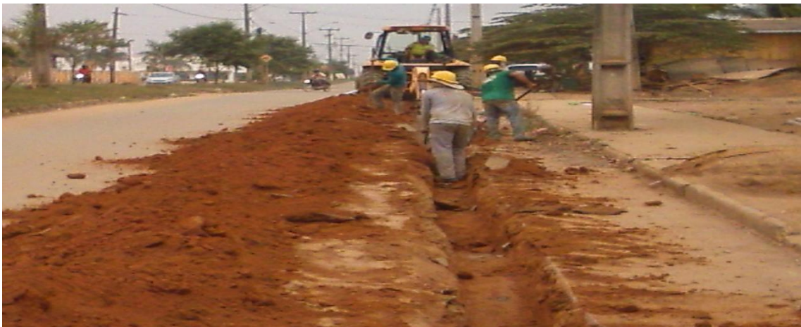
Foto 02: assentamento de rede de distribuição de água de 50mm de PVC- PBA.
