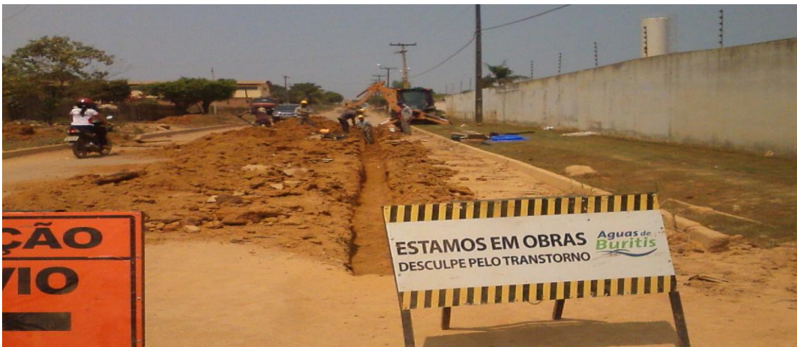
Foto 03: assentamento da rede de distribuição de água de 50mm de PVC – PBA.
