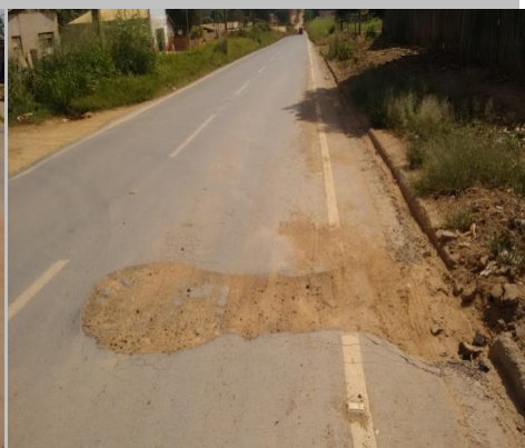
Foto 09: ponto a ser recuperado na Avenida Proto Velho.
