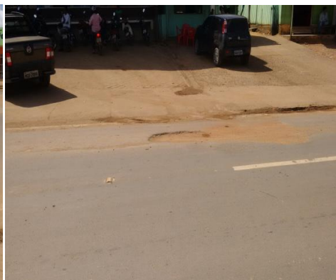
Foto 07: pontos a ser recuperado.
