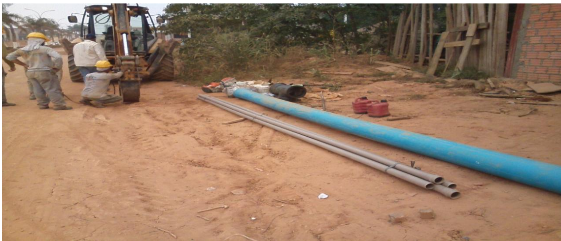
Foto 02: assentamento de uma descarga de 200mm e um (T) ambos de ferro fundido com uma RD 200x50, e tubos de 200mm de FoFo e 50mm de PVC – PBA.
