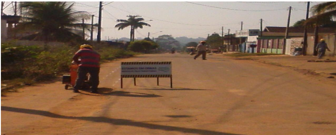
Foto 02: corte no asfalto para abertura de vala e assentamento de rede de distribuição de 50mm de PVC – PBA.
