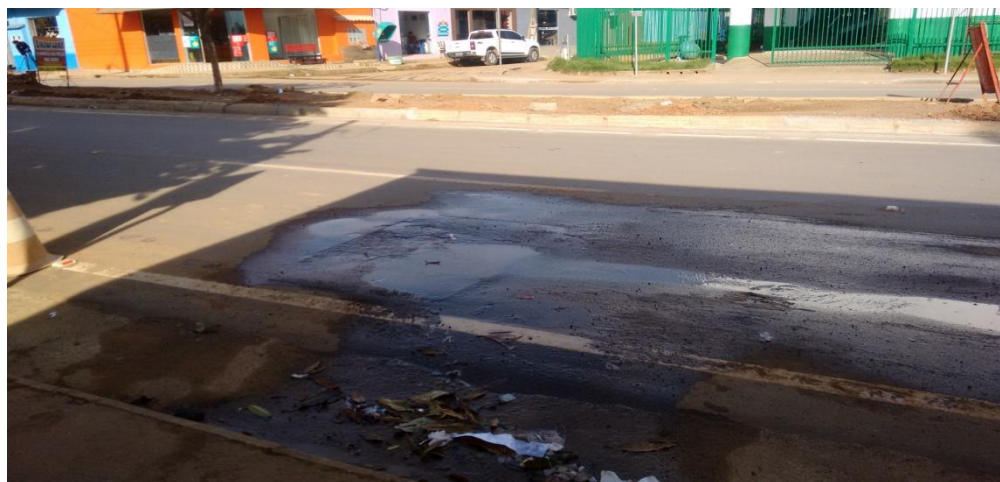
Foto 01: local do vazamento na Avenida Porto Velho
