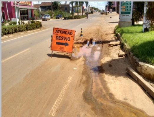
Foto 03: danos no asfalto causado pelo rompimento da tubulação.
