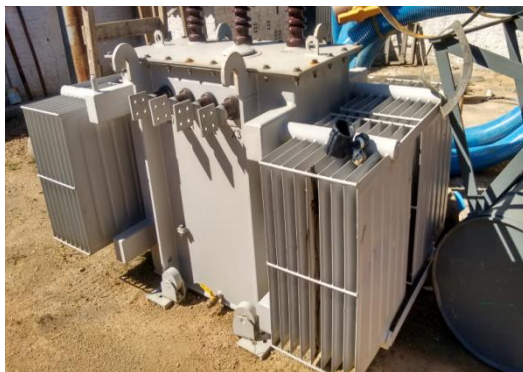
Foto 05: transformador de 3 kVA, nº 192598, NBR 5356.
