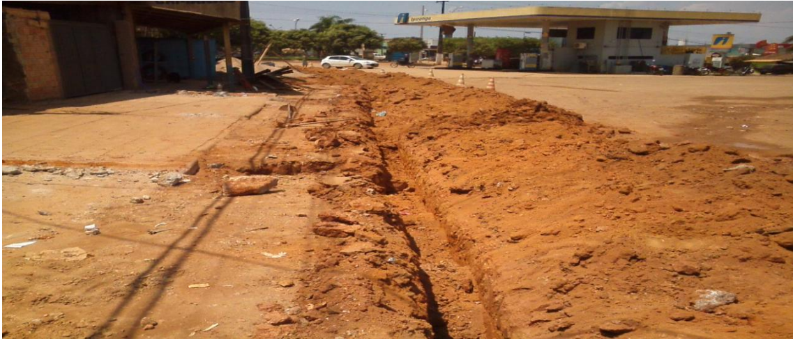
Foto 01: assentamento rede de distribuição de água com tubos de 50mm de PVC PBA.
