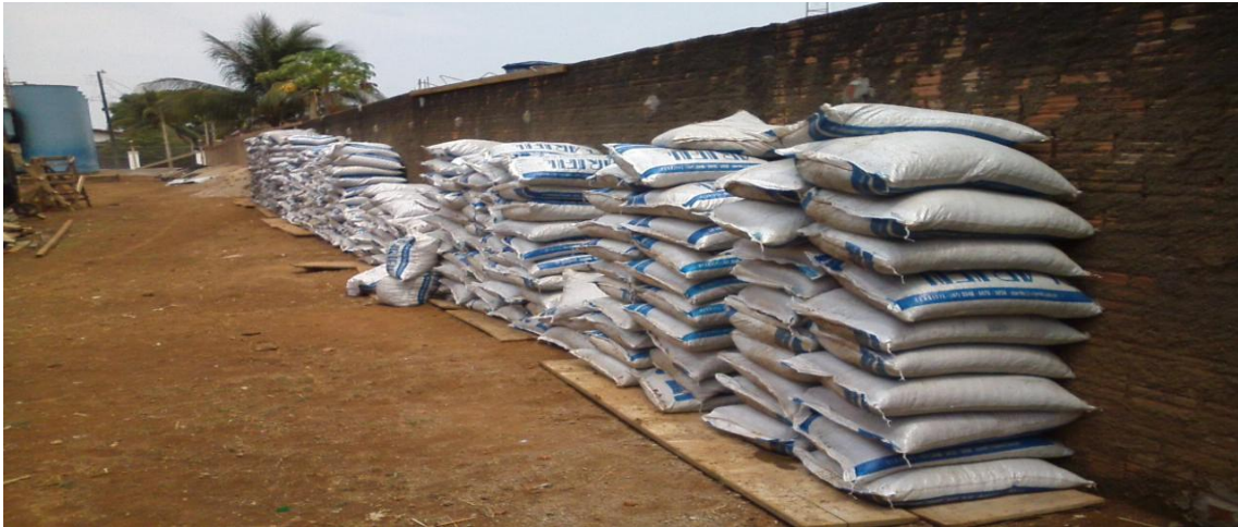
Foto 05: descarregamento de cascalho, areia e carvão mineral para o sistema de filtragem da ETA.
