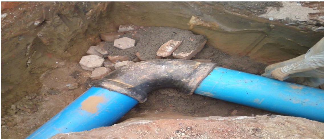
Foto 03: assentamento de curva de 90º de 400mm de ferro fundido na adutora de 400mm de FoFo.
