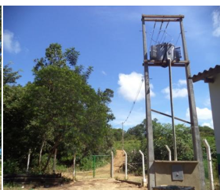
Foto 02: subestação já instalado e inoperante.
