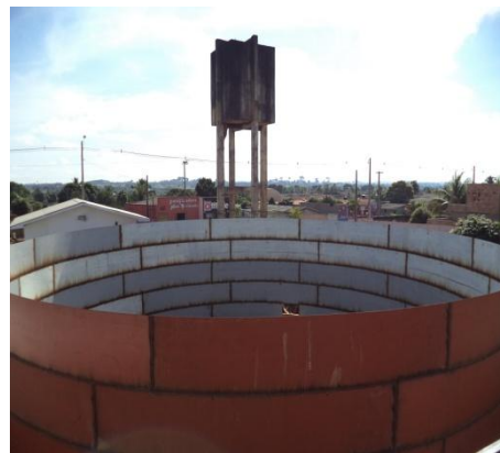
Foto 05: capacidade para 2000 3 de água tratada.
