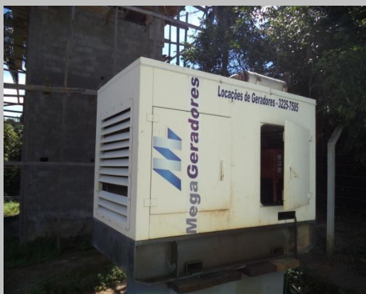
Foto 03: fonte de energia gerado por gerador estacionário.
