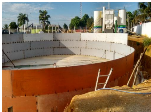
Foto 02: reservatório semi – enterrado com capacidade de 2000m 3 de água tratada.
