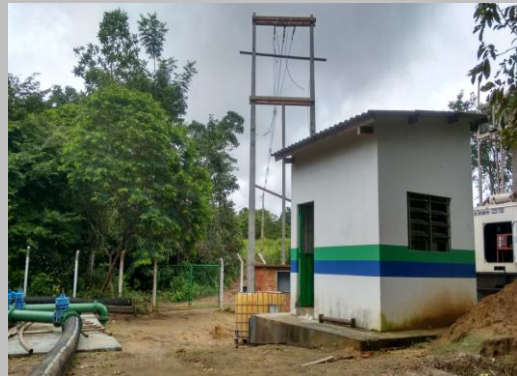
Foto 04: portes com fiação elétrica já instalados inoperantes.
