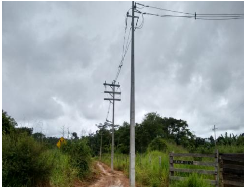
Foto 05: rede elétrica já ampliada à captação.
