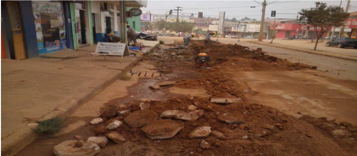
4ª foto: assentamento da rede de distribuição de água tratada de tubulação de 50mm de PVC.
