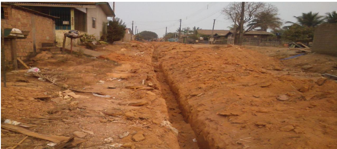
6ª foto: assentamento de rede de distribuição de água tratada com tubulação de 50mm de PVC.
