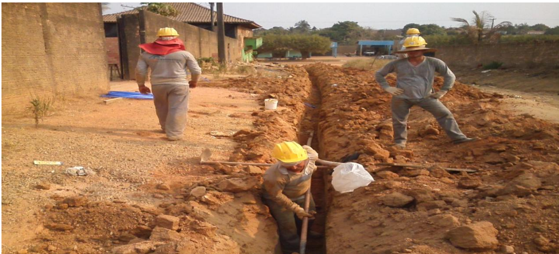
2ª foto: assentamento de tubos de 50mm de PVC para rede de distribuição.
