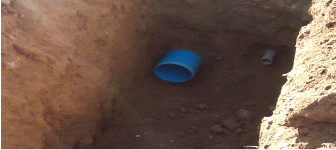
1ª foto: rede de adutora de 200mm de FoFo para captação de água bruta, e rede de distribuição de água tratada de 50mm de PVC.
