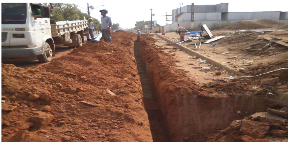
3ª foto: assentamento de tubulações de 150mm de FoFo para rede de distribuição.
