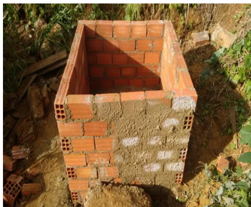
Foto 06: caixa de descarga da adutora.
