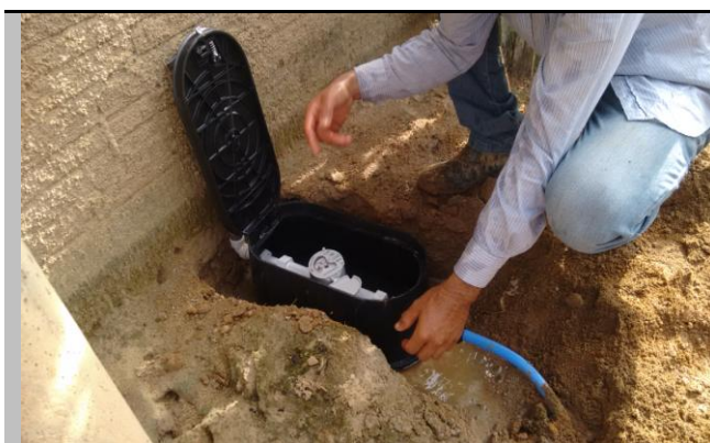
Foto 02: caixa com cavalete e hidrômetro conectado a rede.
